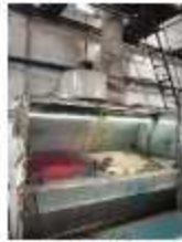
Gambar 7. Unit spray (Sumber: PT Budi Makmur Jayamurni, 2024)
