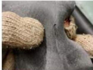
Gambar 7. Cacat retakan pada sambungan bagian dalam.
